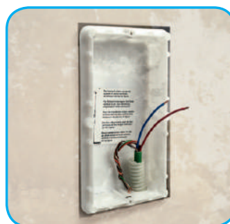
Utilizzo una coppia dei cavi presenti per collegare il nuovo posto esterno.
